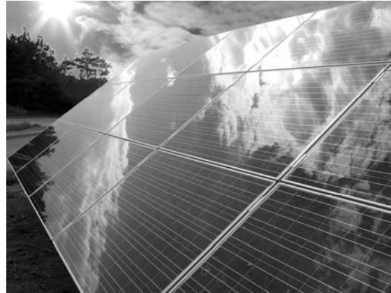
Foto: PV-Thayatal Quelle: oekostrom AG
